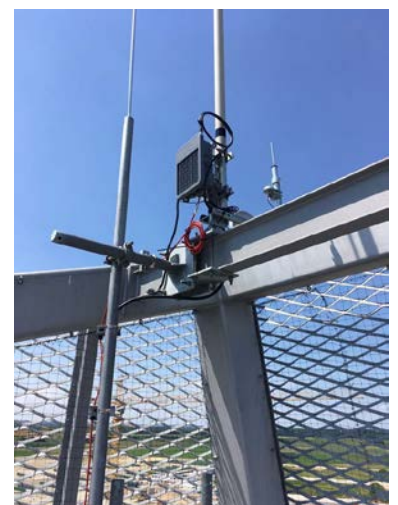
Antenne für das LoRa-Netz auf dem Heizwerk Freiham
